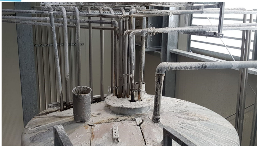
INGRESSO VAPORI SURRISCALDATI PER PRERISCALDO SODA
